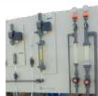
Dosificación de cloro gas
